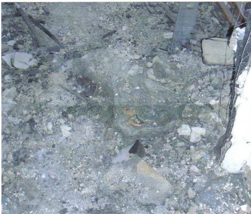
Oben: Fruchtkörper eines Schwamms in der Geschossdecke 1. / 2. OG
